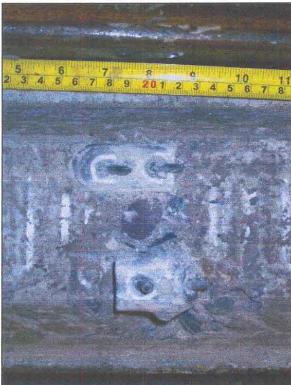
Foto 6. Detalle de la deformación de los conectores de corte.
